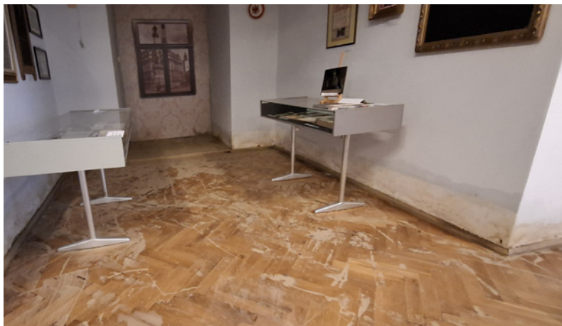
Il. 6. Stan ścian i podłogi po zalaniu sali, fot. NIM
