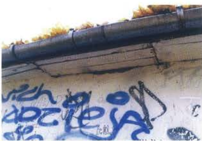
Złodzieje w Muzeum Południowego Podlasia włamując się do obiektu rozebrali część jego dachu. Fot. autor
