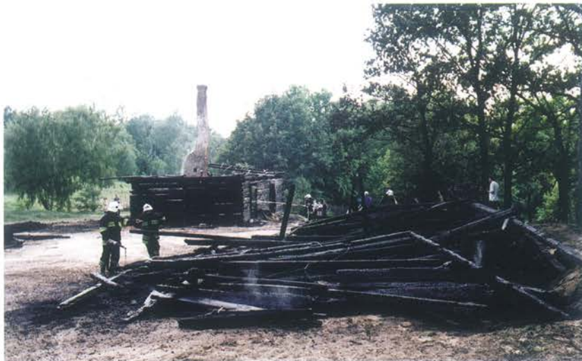
▲ Widok zagrody po pożarze będącym aktem wandalizmu. MWR w Radomiu. Fot. A. Żytnicki
