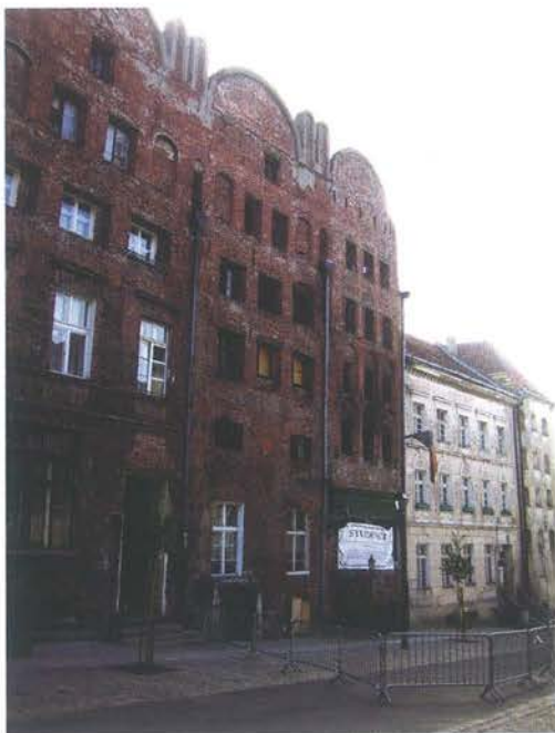
Fasada wypalonej kamienicy w Toruniu. Fot. D.Lipska
