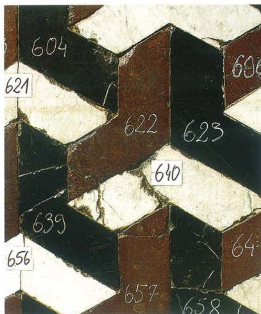
Fragment posadzki przed konserwacją
