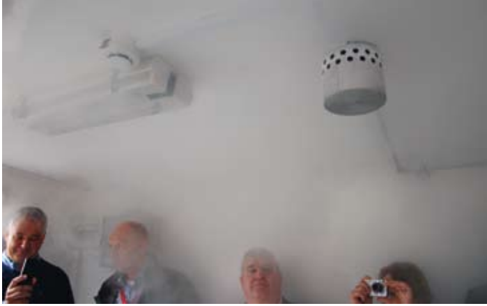
Pokaz użycia gazu gaszącego Inergen. Fot. autor
